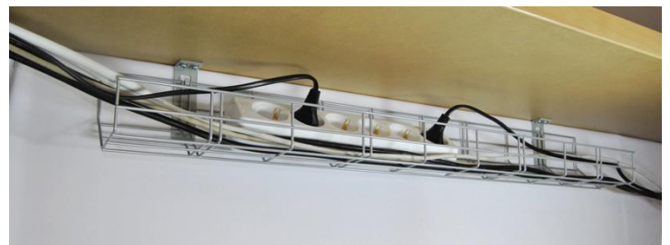
Johtojen lisäksi koriin voi laittaa haaroituspistorasiat, muuntajat yms.
